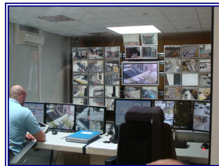
Système de vidéo-protection de la CAVAM à Soisy-sous-Montmorency
